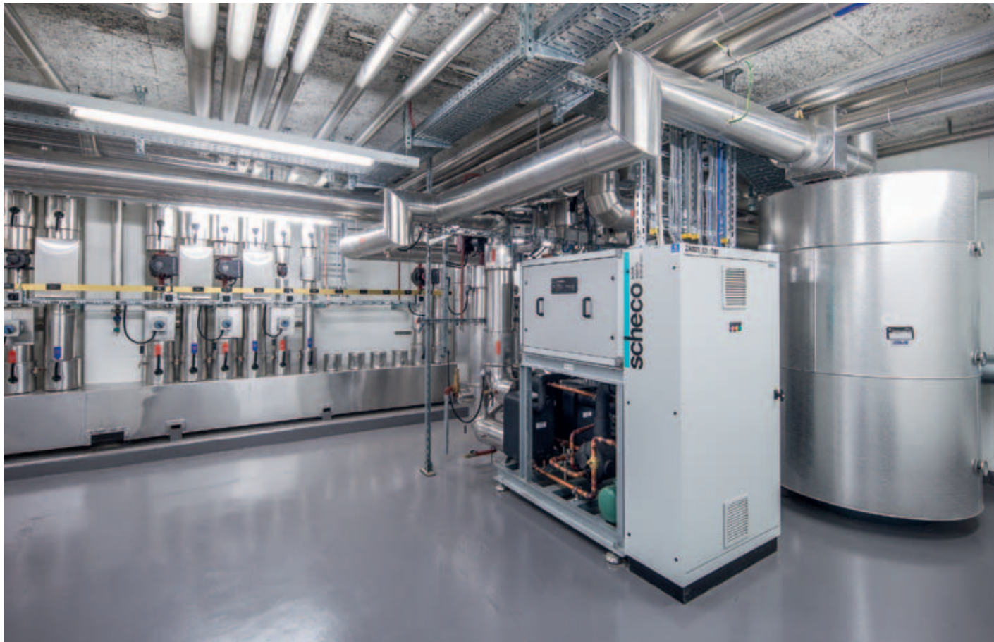
Heizzentrale mit Wärmepumpe
